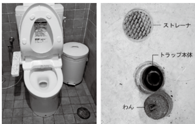
(a) 左床 排水トラップ (b) 床排水トラップの封水の蒸発と劣化
